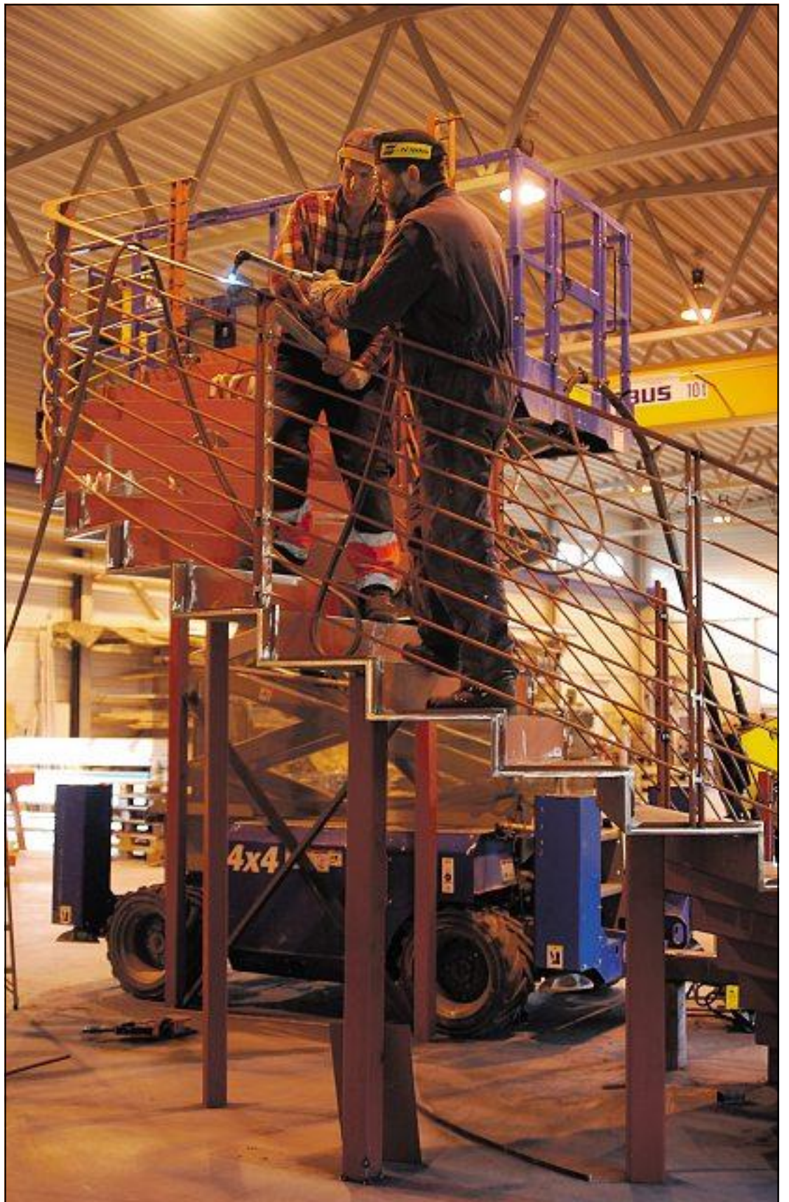
SAMARBEID: Bygginga av den spesielle trappa fordrer både godt samarbeid og tålmodighet, og de egenskapene ser det ut til at Idar Vold og Anders M. Holtén har.
